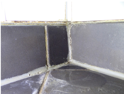
Eksempel på avvik i fuger
