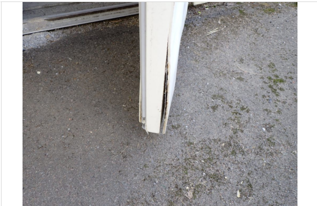
Fuktskade på dør til bod
