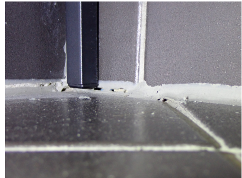
Åpning i fuge, hjørne mot nord
