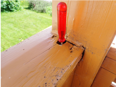
Eksempel på råte
