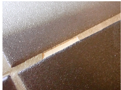
Øvre del av fuging mellom gulvflis løsner
