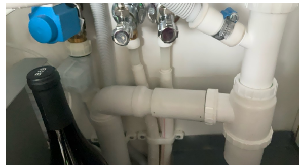
Benkeskap. Det er montert vannstoppventil med sensor under innredning.
