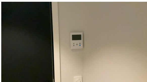
Porttelefon med fjernbetjening av ytterdør er montert ved leilighetsdør.
