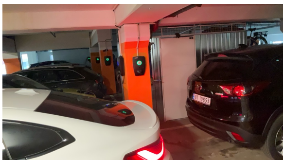
Parkeringsplass med opplegg for EL-billader . Merket 39
