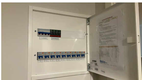
Sikringsskap med automatsikringer er plassert i bod.
