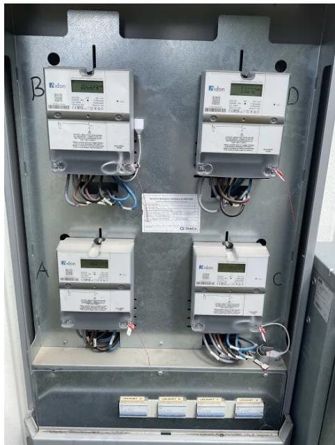
Digital måleravleser i utvendig skap
