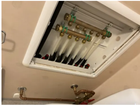
Fordelerskap plassert inne på badetrom
