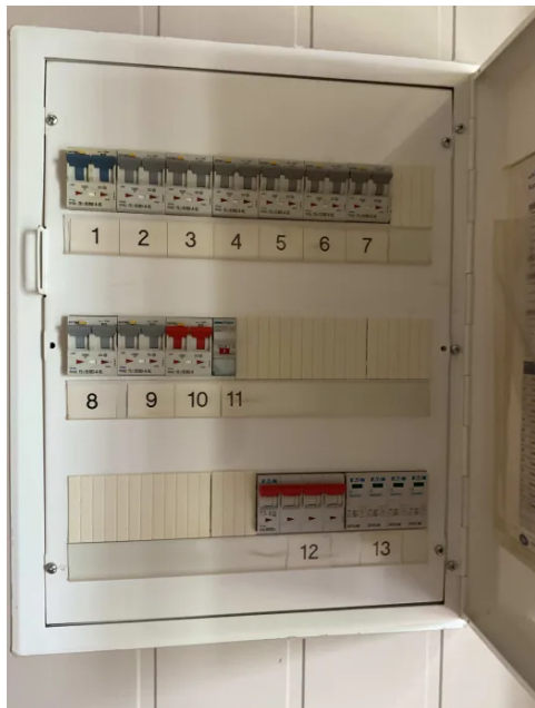
Sikringskapp plassert i gang/entre
