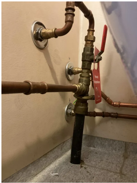
Hovedstoppekrane med synlig merking
