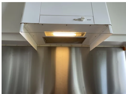
Ventilator tilkoblet sentral avtrekket
