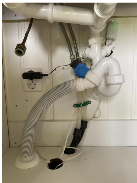
Synlige innvendige avløpsrør i PVC-plast
