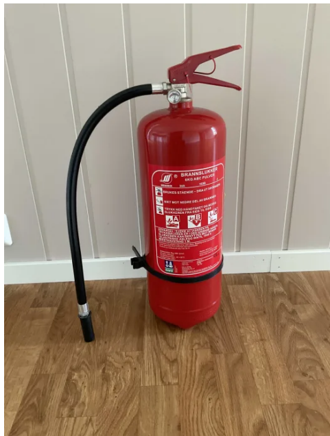
Brannslukningsapparat påvist fra 2013
