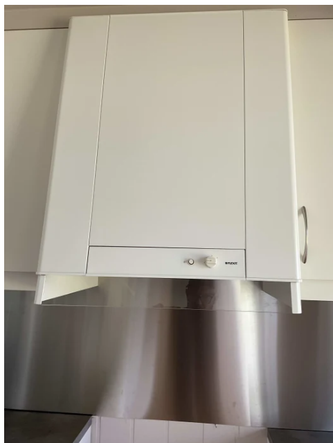
Balansert ventilasjonsanlegg med hastighetsregulering over koketopp
