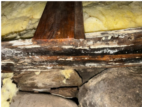
Mugg i konstruksjonen
