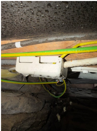
Kondensering på det elektriske anlegget
