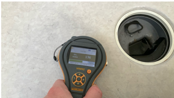
Ved bruk av fuktindikator ble det ikke registrert unormale fuktverdier på tilgjengelige overflater.
