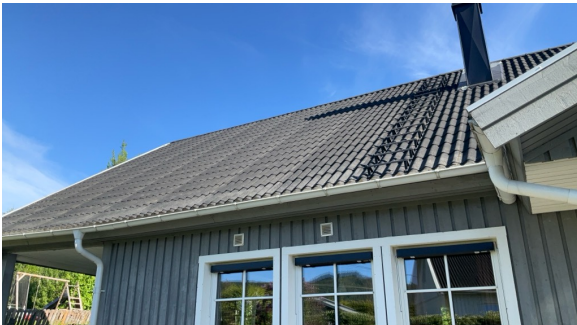
Det mangler snøfanger på hele takflatene.
