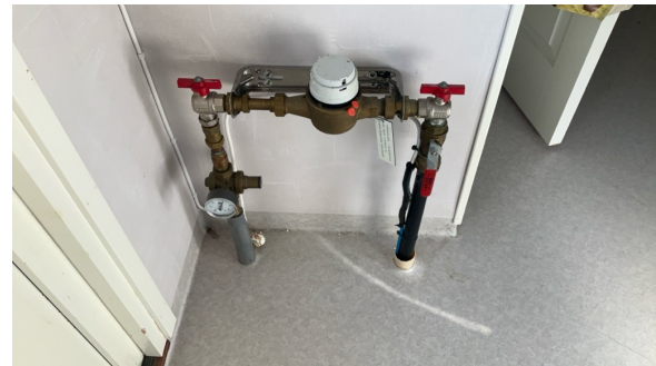
Innvendig hovedstoppekran er plassert i vaskerom.
