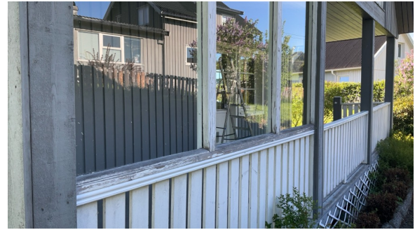
På befaringsdagen var innramming på veranda værslitt. Opplyst at dette blir malt før salg.
