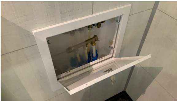
Kurser for rør-i-rør opplegg er ikke merket.
