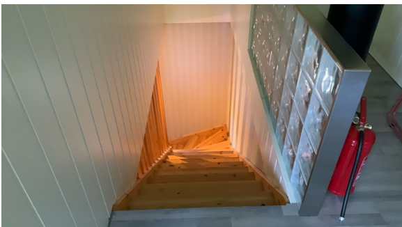
Det mangler håndløper på vegg i trappeløpet.
