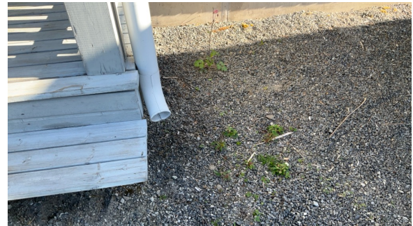
Takvannet ledes ikke vekk fra bygningen.
