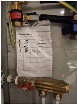
Fordelerskap og fordelerstammer - Kursfortegnelse, rør i rør.
