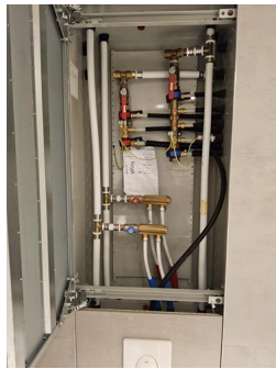
Fordelerskap og fordelerstammer - Fordelerskap, rør i rør.
