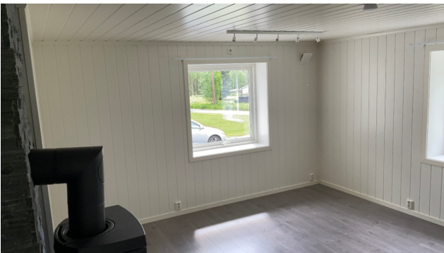
Veggventil i 1. etasje
