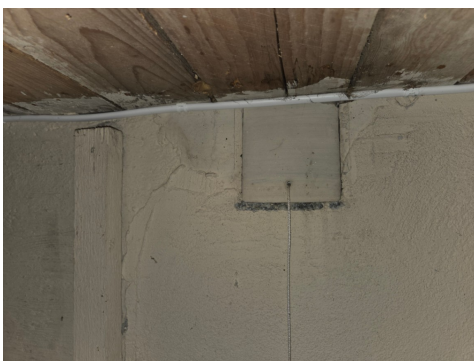
Veggventil i kjelle
