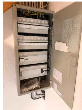
Sikringskap med automatsikringer.
