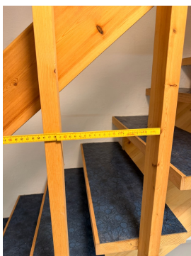
Åpninger i rekkverk er større enn dagens anbefaling.
