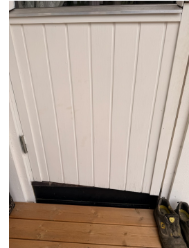
Balkongdøren har værslitt og oppsprukket trevirke i nedre kant utvendig.
