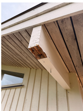
Bærebjelker i gavl mot nord fremstår med råteskader i værutsatte ender.
