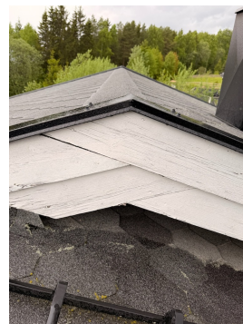
Vindskier fremstår værslitte og oppsprukne, med stedvise råteskader.
