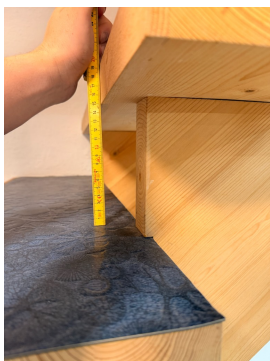
Åpninger mellom opptrinn er større enn dagens anbefaling.
