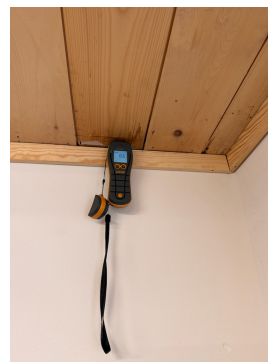
Fuktmåling i himlingen viser tørre forhold.
