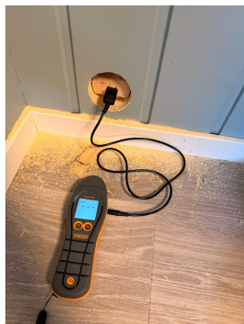
Fuktmåling i tilstøtende konstruksjon bak dusjsjonen.
