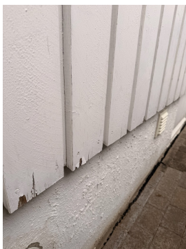
Påvist spredte råteskader i nedre kant av kledningen på værutsatte fasader.
