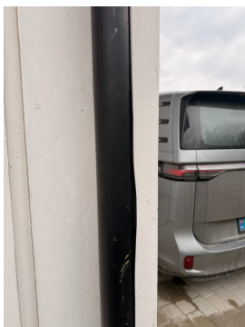
Frostsprengning på nedløpsrør.
