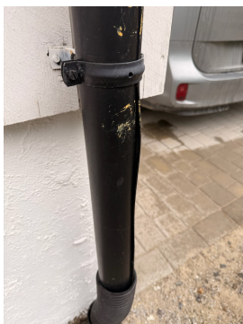
Frostsprengning på nedløpsrør.
