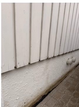
Kledningen er stedvis værslitt og oppsprukket.
