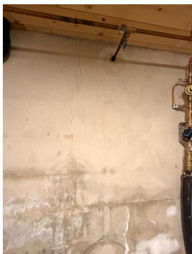
Sprekkdannelse innvendig i kjeller.
