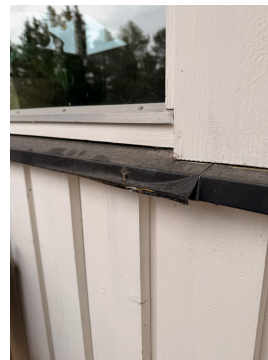
Lakk på utvendig beslag er delvis løst.
