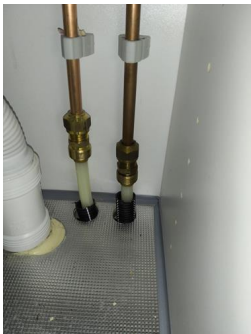
Vannrør - Manglende endeplugg
