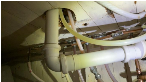
Motfall på rør bør endres til riktig fall..
