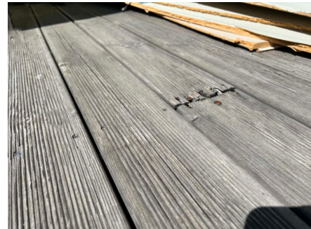
Skade på terrassebord
