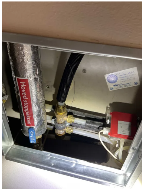
Hovedstoppekran med synlig merking
