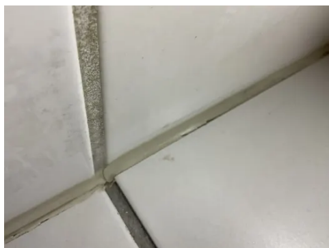
Mykfug med noe krympsprekker, re-fuging må påregnes
