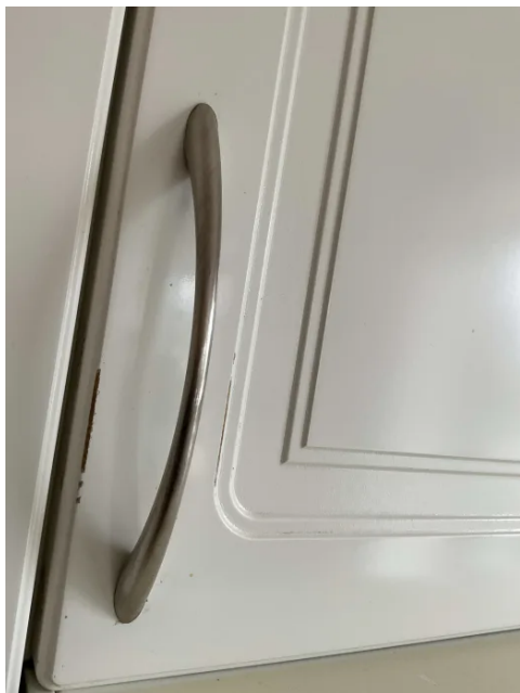
Fronter med noe malingavflassing og lokal slitasje
