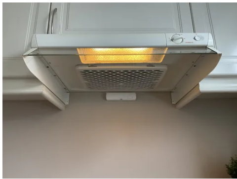
Komfyrvakt montert over koketopp
