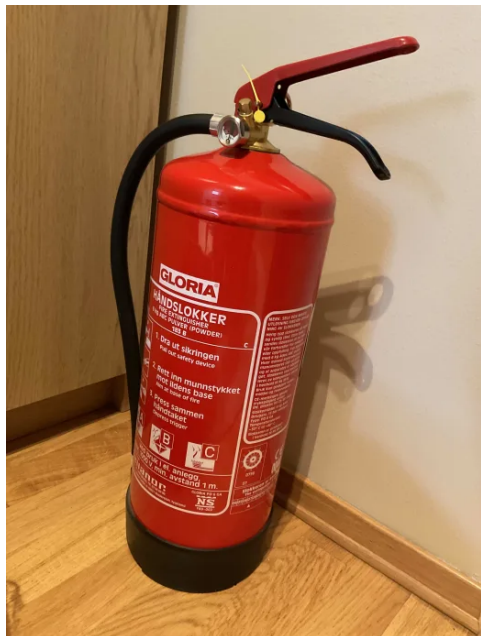
Brannslukningsapparat påvist fra 2007
