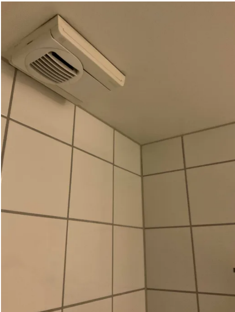
Mekanisk avtrekk med avkast ført via felles ventilasjonssjakt
