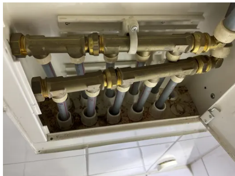
Fordelerskap plassert inne på badetrom
