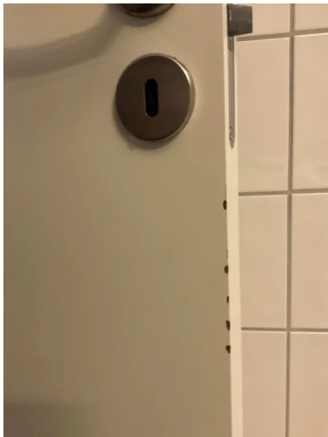
Avflassing og lokal slitasje
