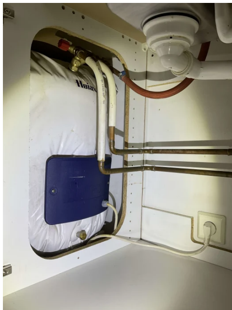
Bereider plassert i benkeskap kjøkken
