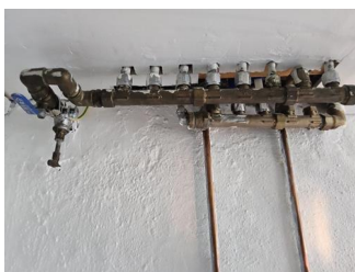
Fordelerskap og fordelerstammer - Fordelerstamme.
