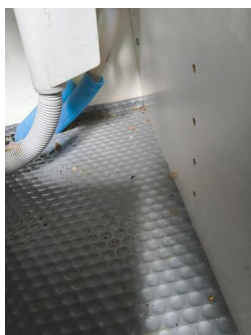
Vannrør - Vannrør under vask
