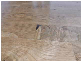
Overflate gulv - Skade i parkett
