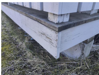
Tilstand på rekkverk og overflatematerialer - Slitt overflatebehandling
