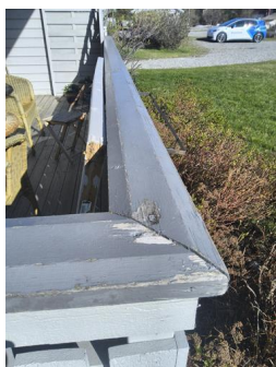
Tilstand på rekkverk og overflatematerialer - Slitt overflatebehandling
