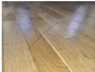
Overflate gulv - Riper i parkett
