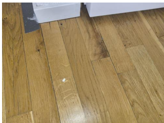
Overflate gulv - Symptomer på svelleskader
