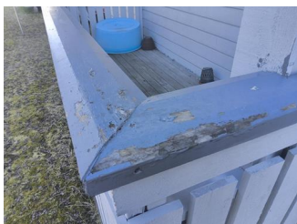
Tilstand på rekkverk og overflatematerialer - Slitt overflatebehandling
