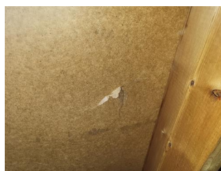
Synlige overflater (taktro, vegger, gulv, o.l) - Skade i undertaket
