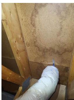
Synlige overflater (taktro, vegger, gulv, o.l) - Fuktskjolder i undertaket
