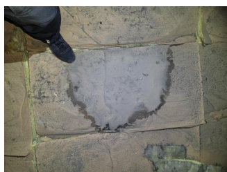
Synlige overflater (taktro, vegger, gulv, o.l) - Fuktskjolder i isolasjonen
