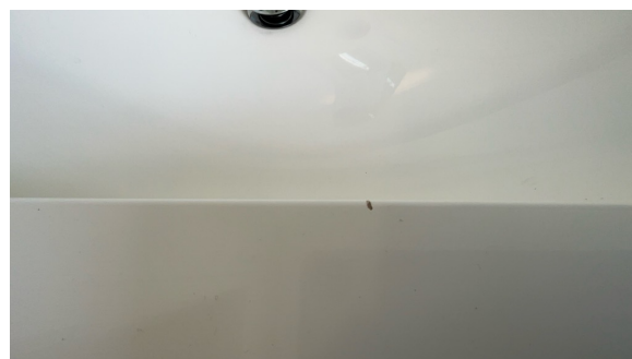
Liten skade i emaljen på servanten
