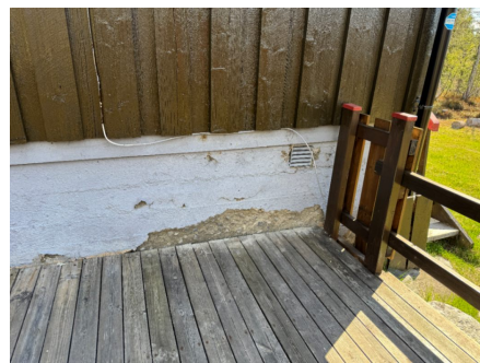
Avflassing på overflater utvendig
