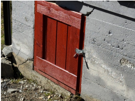
Sprekker i grunnmur rundt luke til krypkjeller
