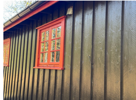
Ikke montert beslag under vinduer
