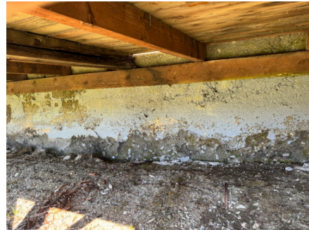
Noe avflassing på overflater av grunnmur
