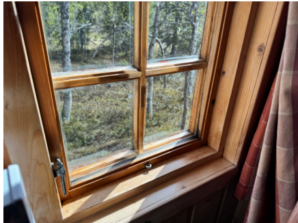
Noe slitasje i vinduer
