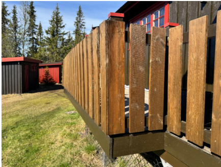
Noe skjevheter i rekkverk
