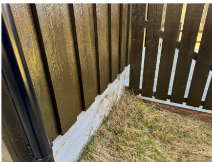
Noe avflassing på overflater utvendig
