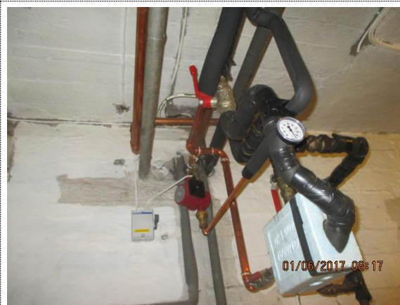
Bilde nr. 18 Isolere vannrør der dette mangler.
