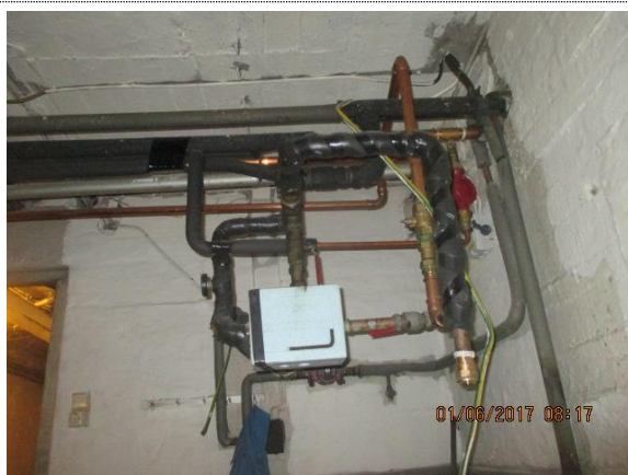
Bilde nr. 17 Isolere vannrør der dette mangler.
