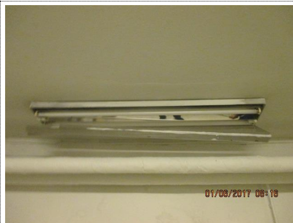
Bilde nr. 24 Skifte belysningen i kjeller til moderne Led belysning med moderne lysstyring.
