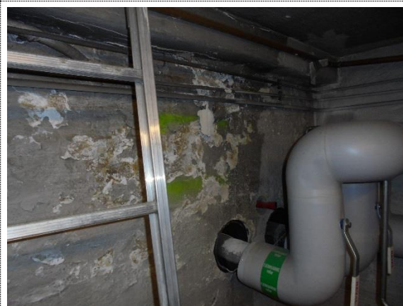
Bilde nr. 12 I fyrrommet er det registrert fuktskader på veggene.
