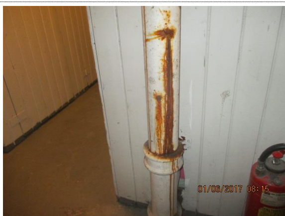
Bilde nr. 15 Gjennomrustet avløpsrør må oppgraderes sammen med badetrom.
