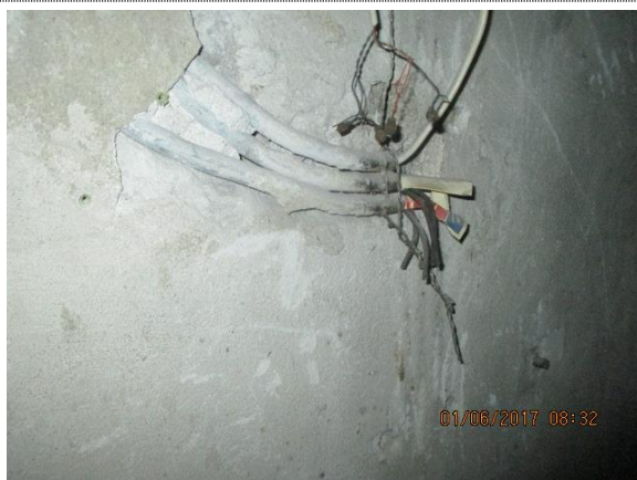
Bilde nr. 27 Fjerne ubrukte el-kabler i kjeller.
