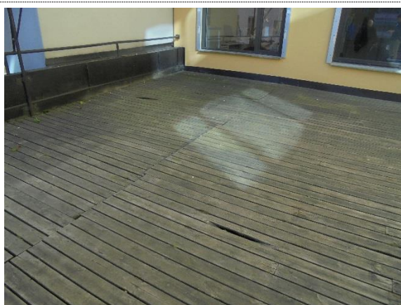
Bilde nr. 7 Plattingen mot bakgården bør byttes.
