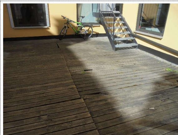
Bilde nr. 8 Plattingen mot bakgården bør byttes.
