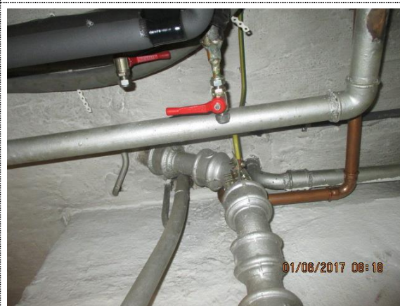
Bilde nr. 16 Gamle avløpsrør og vannrør må skiftes sammen med oppgradering av badetrom.
