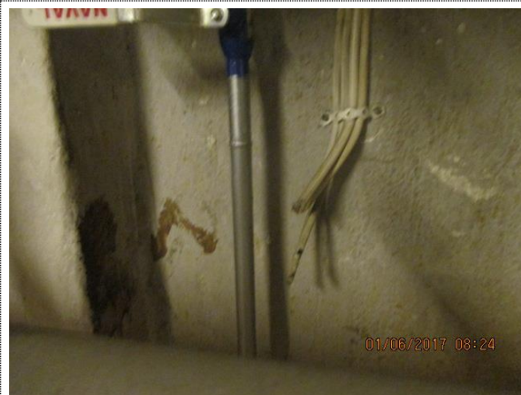
Bilde nr. 28 Fjerne ubrukte el-kabler i kjeller.
