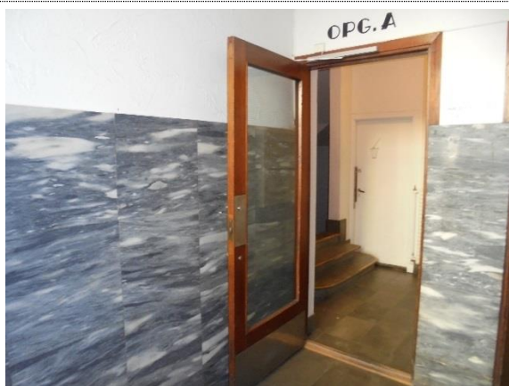
Bilde nr. 11 De glassfelte dørene til trappeoppgangene tilfredsstillers trolig ikke kravene til brann- og røyktetthet og bør byttes.
