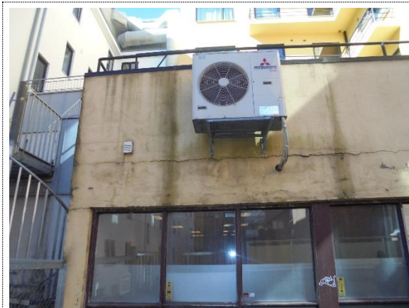
Bilde nr. 2 Mot bakgården er det registrert en horisontal sprekk i fasaden som trolig kommer av fukt fra oversiden.
