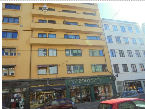
Bilde nr. 1 Fasaden mot gateplan er nylig rehabilitert, og fremstår i god stand.
