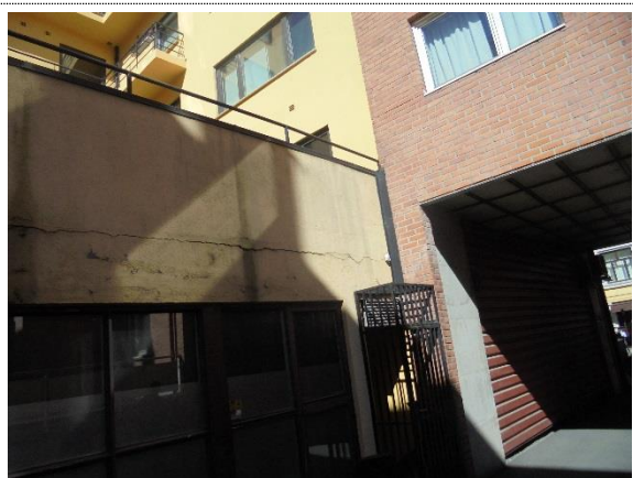
Bilde nr. 3 Mot bakgården er det registrert en horisontal sprekk i fasaden som trolig kommer av fukt fra oversiden.
