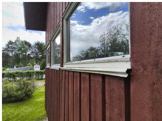
Vinduer og omramming - Manglende fall og slitasje
