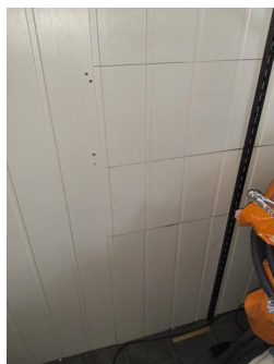
Innvendige forhold - Skader og glipper i innvendig platerkleddning
