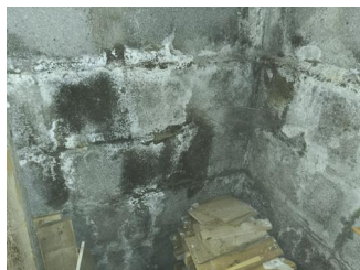
Overflate vegg - Salt og kalkutslag
