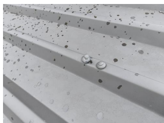
Tekking (med tilhørende beslag) - Uttehet og løs skrue
