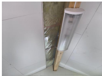
Innvendige forhold - Manglende himlingsplater
