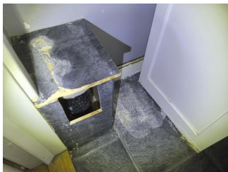
Overflate gulv - Svelleskader ved servant og lufting til avløpsrør
