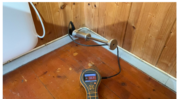
Fuktmåling med hammerelektrode i påforet vegg mot terreng viste skadelige verdier.
