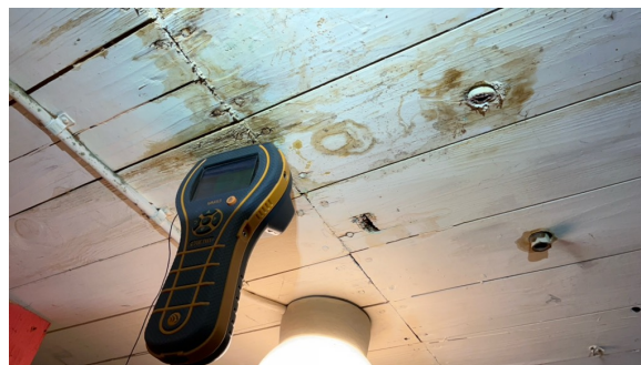
Fuktmerker i himling flere steder i underetasje, fuktmålinger viste tørre verdier.
