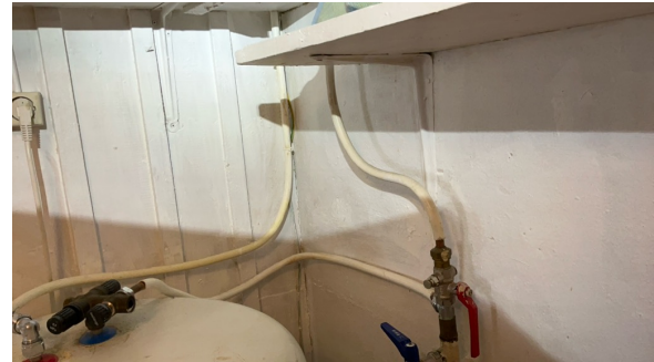
Enkelte eldre rør i boligen, mye av anlegget er skiftet senere år.
