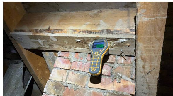
Fuktmerker og misfarging flere steder, fuktmåling viste tørre verdier på tilgjengelige steder.
