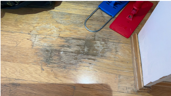
Eksempel på skadet parkettgulv.
