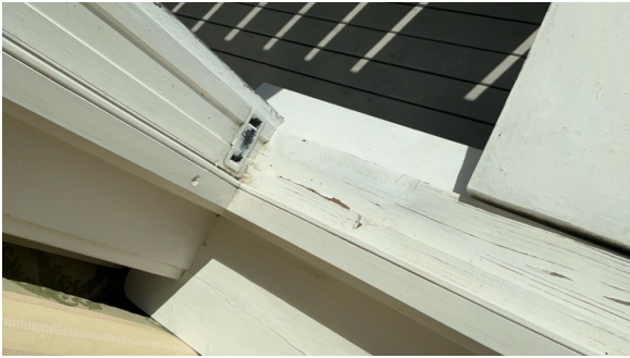
Eldre vinduer bærer preg av slitasje.
