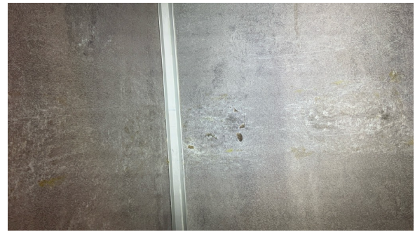
Skade på overflate veggplate i dusjsone.
