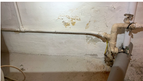
Saltutslag og skader på overflater.
