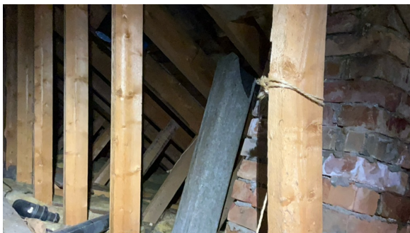
Eternittkanal på kaldtloft. Dette kan kreve spesialtiltak ved fjerning.
