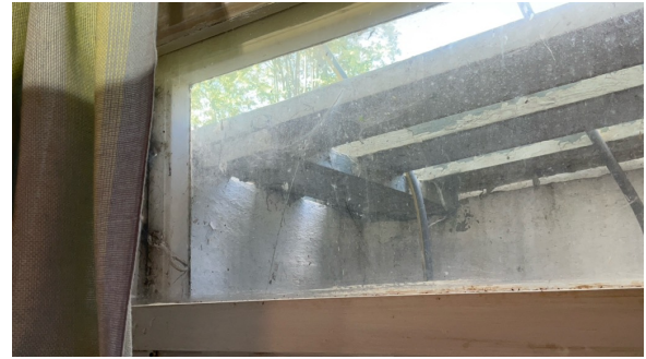
Sprukket kjellervindu registrert.
