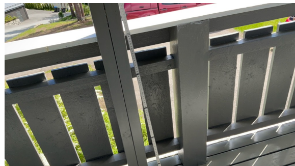
Veranda har for lavt rekkverk i henhold til dagens krav.
