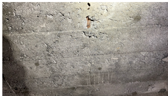
Sprekk i betongdekke og synlig korrosjon på armeringsjern sett fra garasje. Anbefaler å følge med på videre utvikling.
