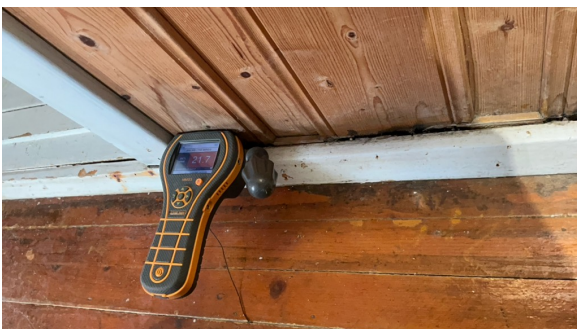
Råteskadet panel i delevegg mellom soverom og bod, selger opplyser at årsaken er eldre lekkasje fra gammelt avløpsrør som er skiftet. Fuktmåling viste skadelige verdier.
