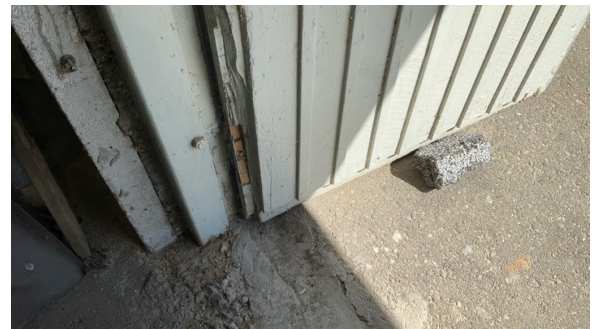
Garasjeport bærer preg av slitasje.
