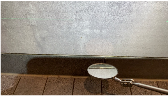
Utettheter mellom sokkelskinne og baderomspanel, det er indikasjoner på fuktopptrekk. Misfarging på fuger flere steder.
