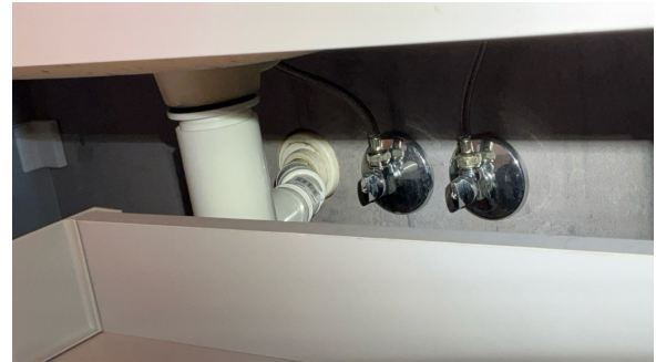
Manglende tetting rundt gjennomføring under servant.
