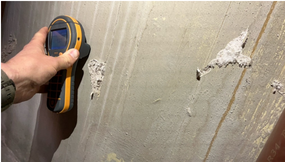
Saltutslag flere steder. Fuktsøk viste forhøyde verdier.
