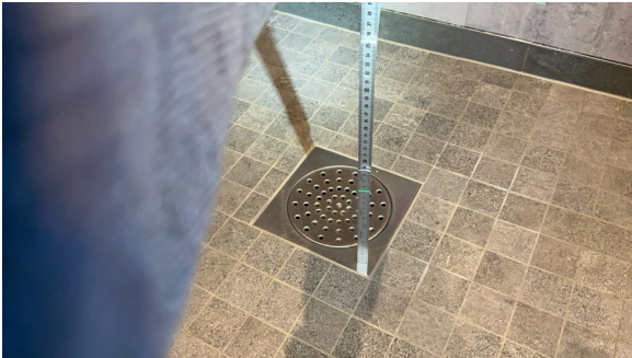
Høydefoskjell på ca. 20 mm mellom gulv dørterskel og slukrist.
