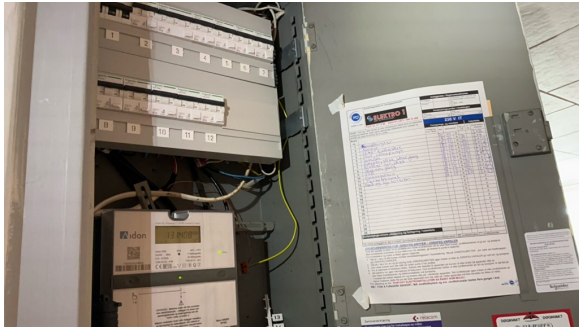
Sikringskap i underetasje.
