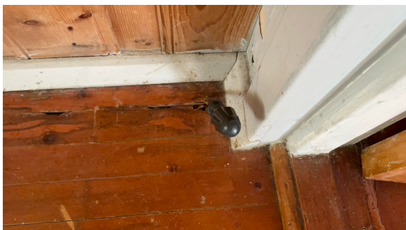
Noe råteskader registrert på gulv soverom i underetasje. Se også "rom under terreng" i rapporten.
