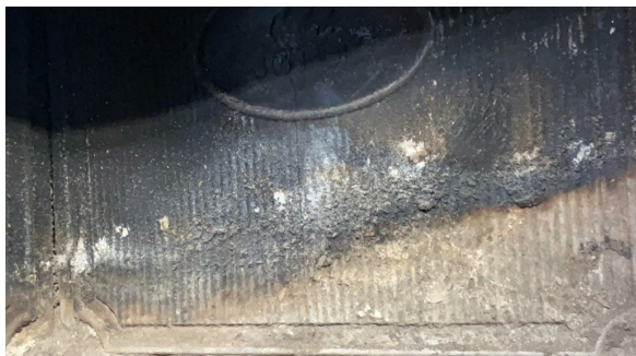
Sprekk i ildfast stein i peis 1. etasje.
