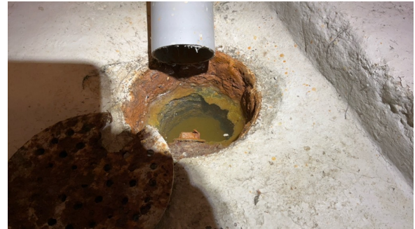
Kontroll av sluk, synlig rust. Det er ikke membran på våtrommet.
