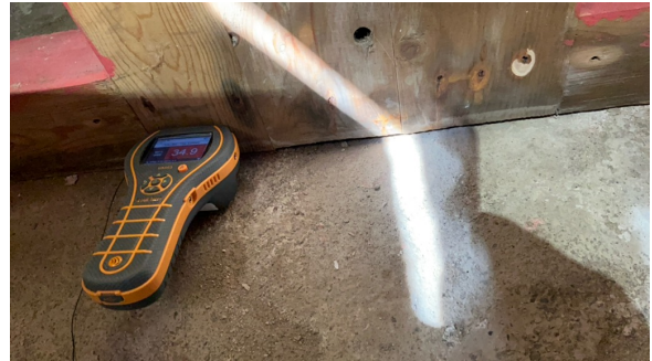
Fuktmåling på treverk mot betonggulv viste skadelige verdier.
