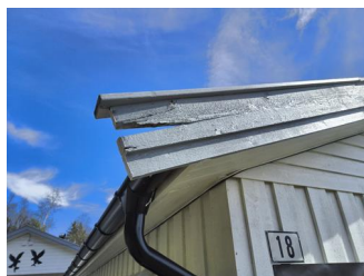
Yttertak og takkonstruksjon - Skade i vindskibord
