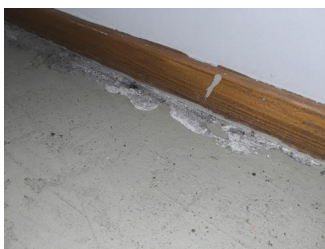
Overflate gulv - Skader i gulvets overflatebehandling
