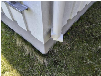
Takrenner og utvendige nedløp - Skadet feste til nedløp
