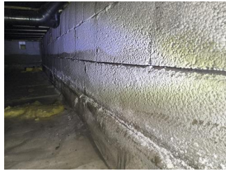
Synlige konstruksjoner - Symptomer på jordtrykk skade
