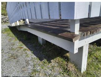
Tilstand på rekkverk og overflatematerialer - Løst terrassebord
