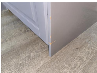
Innredning - Skade i dekkplate
