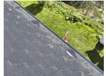
Tekking (med tilhørende beslag) - Skadet shingel
