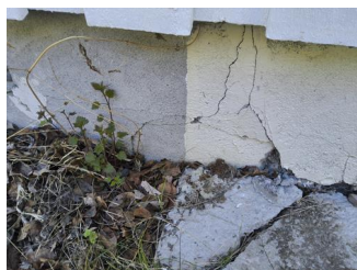
Grunnmur og fundament - Sprekker i grunnmur
