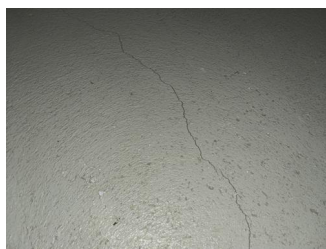
Overflate gulv - Riss i betong gulv
