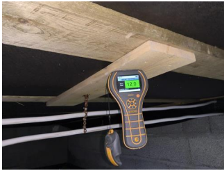
Stikktaking i treverk, fukt og fuktmålinger - Fuktmåling
