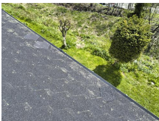
Tekking (med tilhørende beslag) - Skadet shingel
