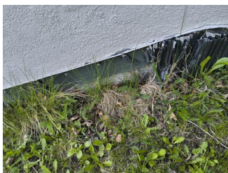
Fuktsikring av grunnmur - Skade i fuktsperre
