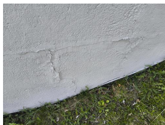
Grunnmur og fundament - Avskalling av murpuss
