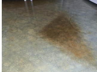
Overflater gulv - Misfarging i gulvbelegg
