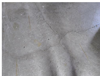
Fundament, grunnmur og gulv mot grunn - Riss i gulv
