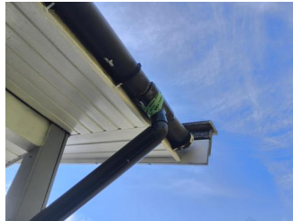
Takrenner og utvendige nedløp - Skade i takrenne
