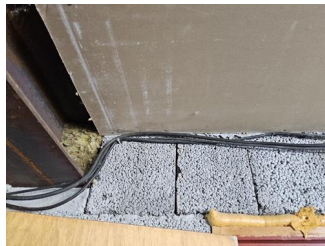
Annet - Manglende gass/eksos tetting til øvrige rom
