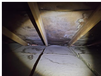
Synlige overflater (taktro, vegger, gulv, o.l) - Fuktmerker/skader på undertak
