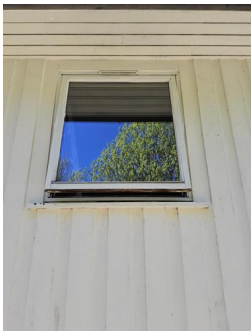
Vinduer og omramming - Stedvis slitasje på vinduer.
