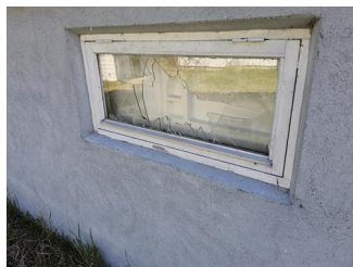
Vinduer og omramming - Knust glass på vindu til garasje.
