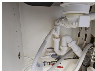
Innredning - Røropplegg i kjøkkenbenk
