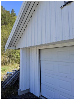
Veggkonstruksjon og fasadematerialer - Tegn på slitasje av fasader.
