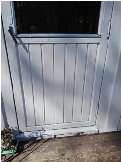
Ytterdører og omramming - Slitasje på terrassedører
