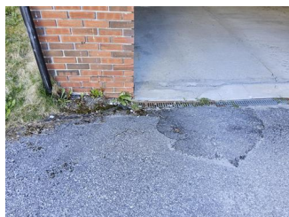
Terrengfall fra grunnmur - Fall inn mot bolig, her ved garasje
