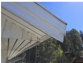
Vannbord, vindskier, gesimskasser og lignende - Slitasje vindskier
