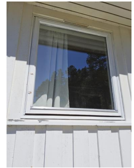
Vinduer og omramming - Slitasje vinduer
