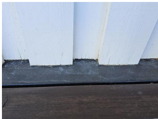
Ytterkledning (fasademateriale, vannbord, utvendig listverk, o.l.) - Oppsprekk/slitasje, ikke tilstrekkelig klaring mot beslag.
