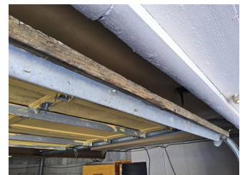
Ytterdører og omramming - slitasje på port
