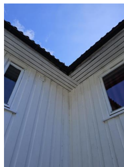
Vannbord, vindskier, gesimskasser og lignende - Tegn på råte i kassebord under kilrenne.
