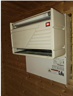
Tekniske anlegg (kjøleaggregat, badstueovn med mer) - -
