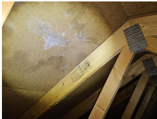
Synlige overflater (taktro, vegger, gulv, o.l) - Muggskjolder
