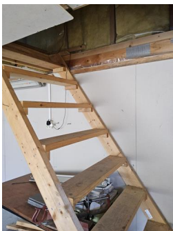
Innvendige forhold - Trapp ikke i henhold til sikkerhet
