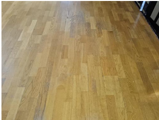
Overflate gulv - Slitasje gulv
