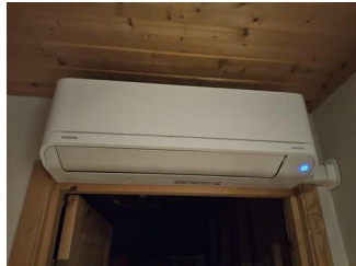
Varmepumper - Varmepumpe i underetasje
