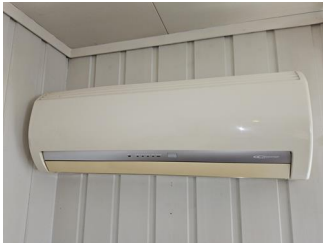
Varmepumper - Varmepumpe i stue
