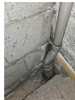
Overflate vegg - Saltutslag og fuktmerker på vegg i uinnredet bod.
