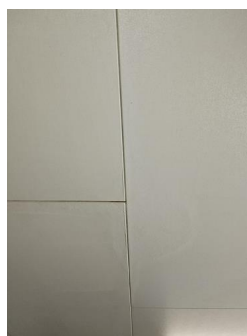
Overflate himling - Tegn på svellemerker i himlingsplater, kan stamme fra tidligere ventilasjonssystem.
