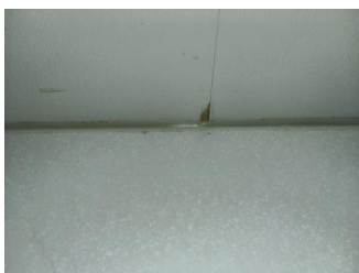
Overflate vegg - Skade i veggflate
