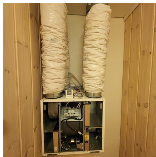
Mekaniske ventilasjonsanlegg (utover det som nevnes under andre sjekkpunkter) - .
