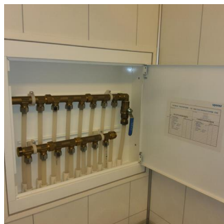
Fordelerskap og fordelersstammer
