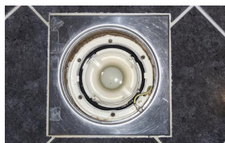
Avløp (inkl. sluk) - Sluk bad 1.etasje
