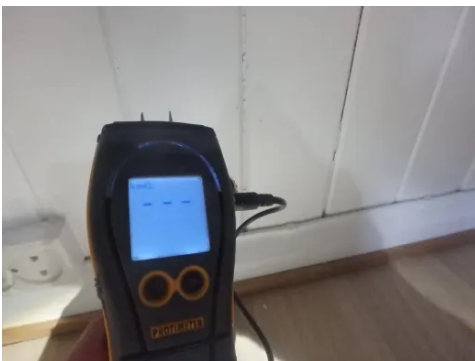
Fuktmåling i tilstøtende vegg fra loftstue.
