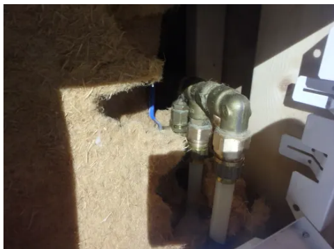
Koblingspunkt i vegg på stue mot øst.
