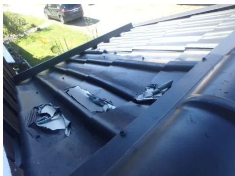
Ujevnhet og lakkavskalling i takteking.
