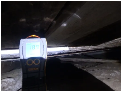
Fuktmåling i stubbloftsgulv.
