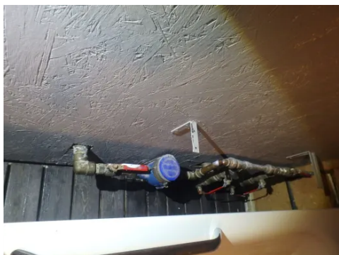
Hovedstoppekrane og vannmåler i kjeller vest.
