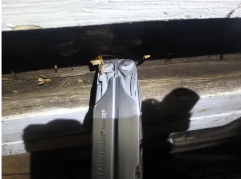
Råte i stubbloftsgulv.
