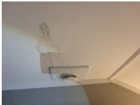
Fuktmerker i tak ved ventil.
