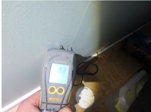
Fuktmåling i vegg fra tilliggende soverom.
