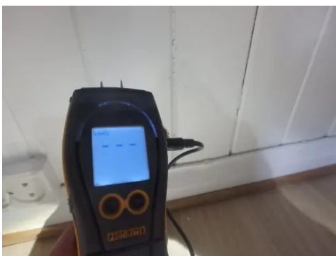
Fuktmåling i tilstøtende vegg fra loftstue.
