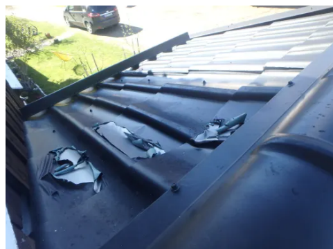
Ujevnhet og lakkavskalling i takteking.
