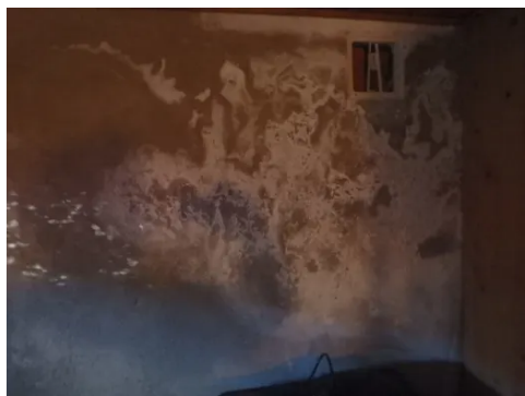
Åpne murvegger med salt/kalkutslag.
