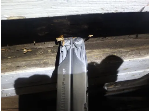
Råte i stubbloftsgulv.
