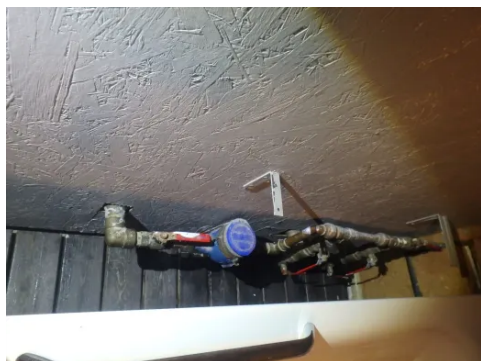
Hovedstoppekrane og vannmåler i kjeller vest.
