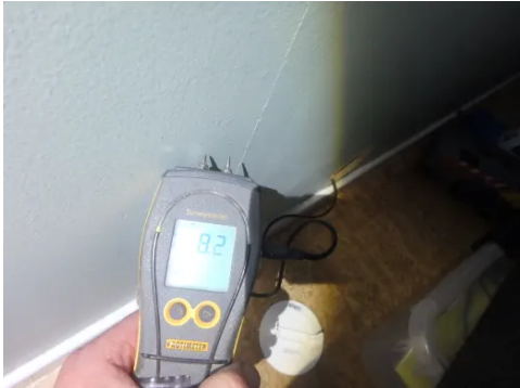
Fuktmåling i vegg fra tiliggende soverom.
