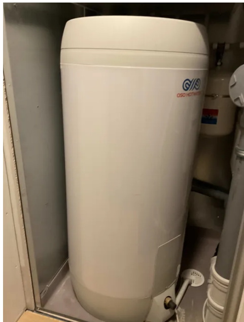
Bereder plassert inne på teknisk rom
