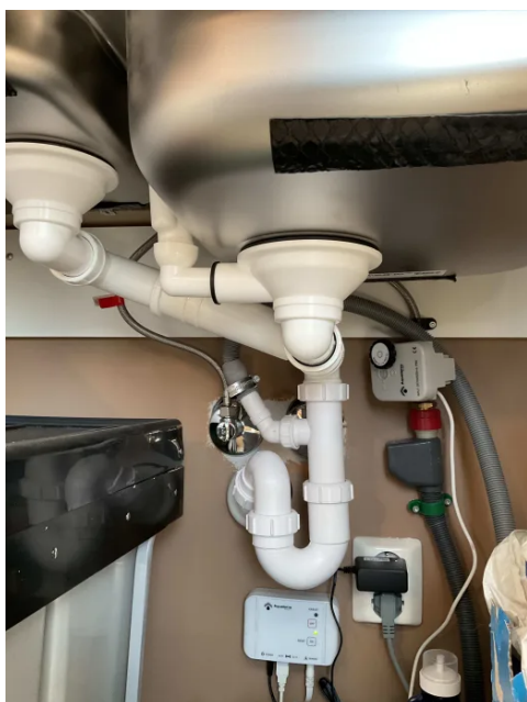
Synlige innvendig avløpsrør med PVC-plast
