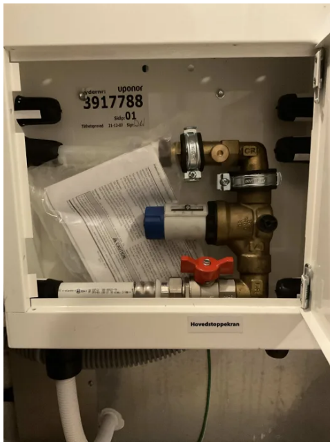
Hovedstoppekran med synlig merking inne på teknisk rom
