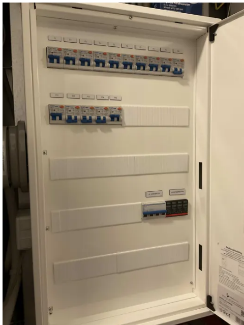
Sikringskapp plassert inne på teknisk rom/innvendig bod
