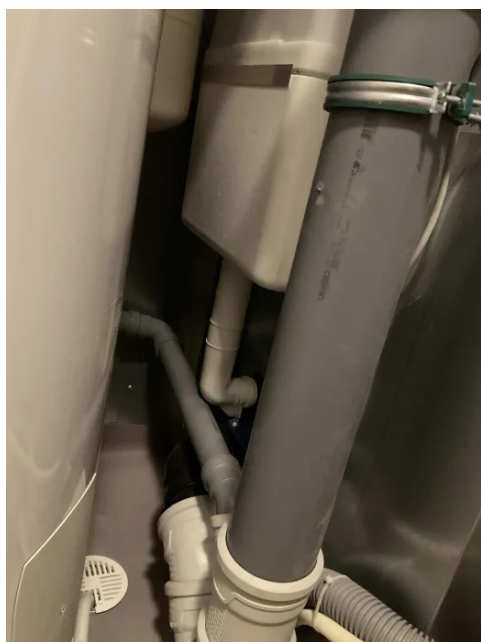
Åpen sisterner mot teknisk rom
