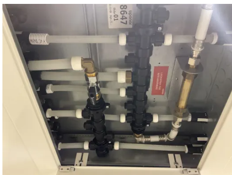
Fordelerskap plassert i himling på badetrom
