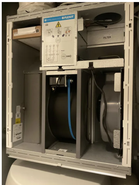
Balansert ventilasjon med varmegjenvinner
