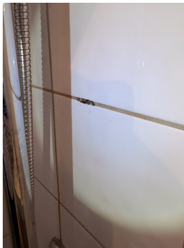
Hull i fuger trolig etter tidligere innfestning av dusjgarnityr.
