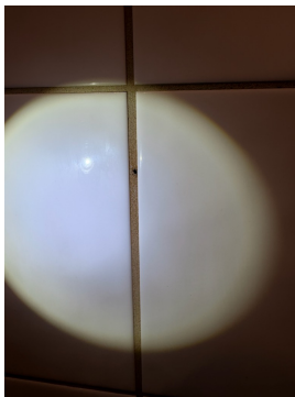
Mindre hull i fuger forekommer.
