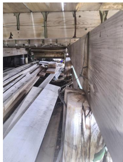
Konstruksjon og fundamenter - Skjevheter i søyler
