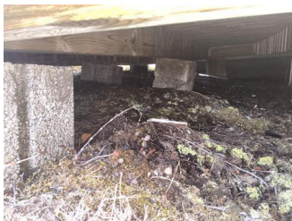
Konstruksjon og fundamenter - Skjevheter i fundamenter
