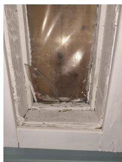
Vinduer, dører og porter - Sprukket vindu
