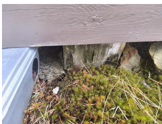
Fundament, grunnmur og gulv mot grunn - Råte i søyle
