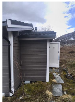
Fundament, grunnmur og gulv mot grunn - Skjevheter i konstruksjonen
