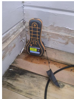
Innvendige forhold - Fuktmåling
