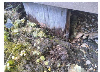
Fundament, grunnmur og gulv mot grunn - Råte i søyle
