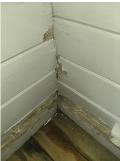
Innvendige forhold - Fuktmerker og skader i overflatebehandling
