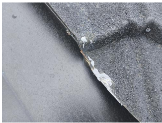
Tekking (med tilhørende beslag) - Området med overflaterust
