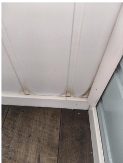
Innendige forhold - Fuktmerker på vegg
