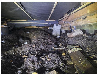
Grunnmur og fundament - Skjevheter i søyle/fundament
