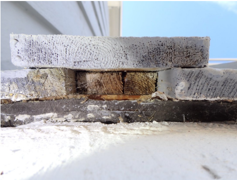
Eksempel på noe manglende lufting
