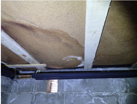
Fuktskader ved ventil mot sør
