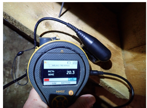
Fuktmåling ved pipa
