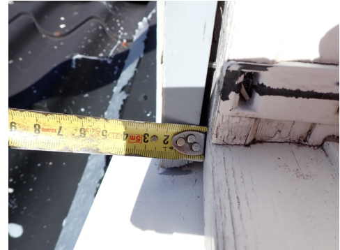
Stor glippe mellom utvendig omramming og vindu
