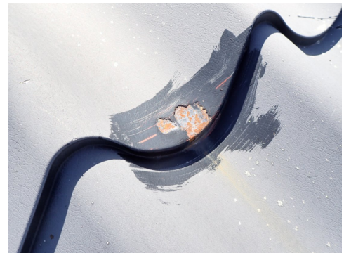
Eksempel på rustflekker
