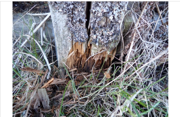
Eksempel på råte i søyler
