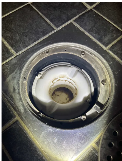
Slukmansjett synlig ført under klemring
