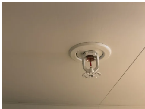
Bolig utført med sprinkelanlegg
