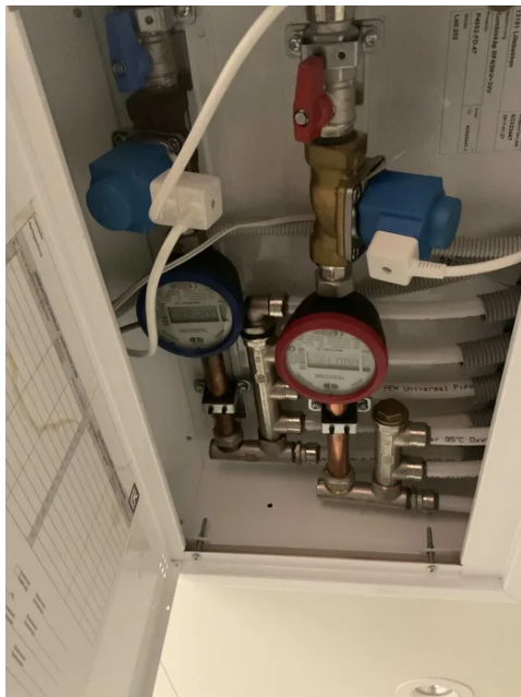
Stoppekran plassert i himling inne på badetrom
