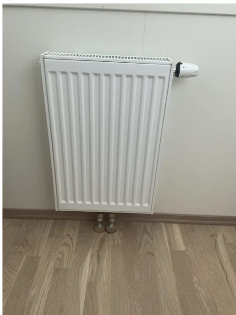
Anlegget er tilkoblet radiatorovner
