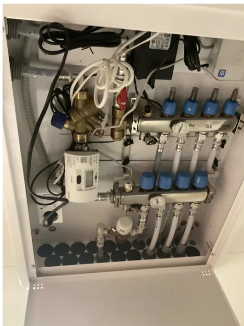
Fordelerskap plassert i himling inne på badetrom
