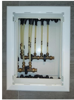
Fordelerskap og fordelerstammer - Fordelerskap
