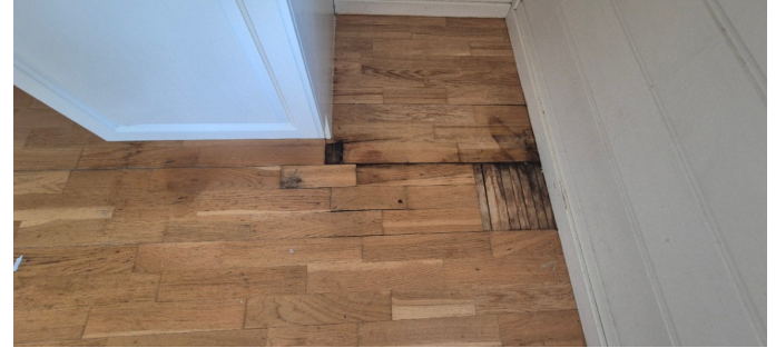
Skadet gulv ved kjøkkeninnredningen
