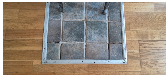
Løse fuger og fliser
