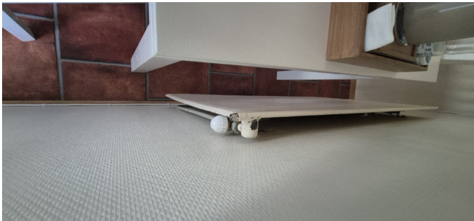
Radiator på kjøkken
