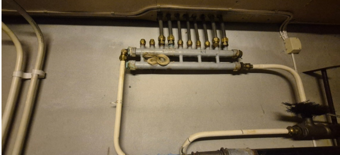
Fordeling av radiatorrør i fyllrom
