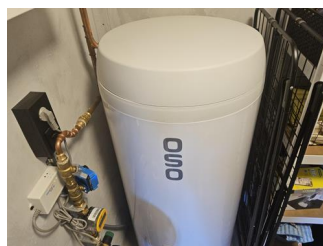
Varmtvannsbereder - Plassert i bod.
