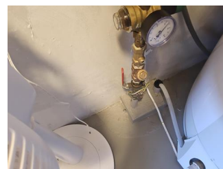
Innvendig stoppekran - Plassert i bod.
