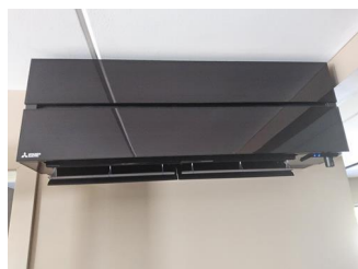
Varmepumper - Plassert i stue.
