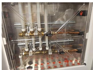
Fordelerskap og fordelerstammer - Plassert i bod.
