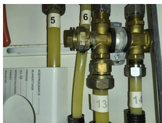
Fordelerskap og fordelerstammer - Drypplekkasje i fordelerskap
