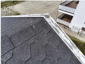
Vannbord, vindskier, gesimskasser og lignende - Slitasje på vannbord
