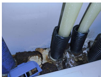
Fordelerskap og fordelerstammer - Rustskader i fordelerskap
