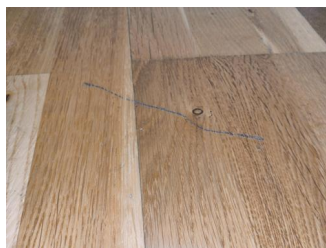
Overflate gulv - Ripe/skade i gulv
