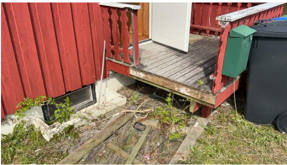
Trap ved inngang er revet
