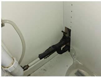
Innvendig stoppekran - IMG_20260520_09310
