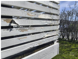
Tilstand på rekkverk og overflatematerialer - Slitt overflatebehandling
