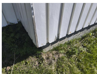
Overflatebehandling - Slitt/skadet overflatebehandling
