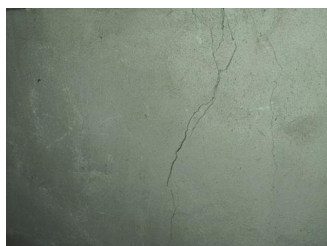
Overflate vegg - Sprekker i grunnmur
