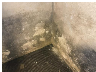
Overflate vegg - Synlige fuktmerker og avskalling av murpuss
