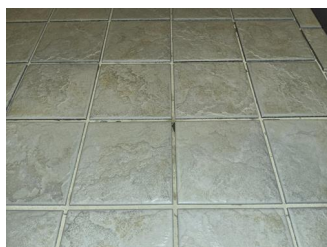
Overflater gulv - Slitasje og skade i flisfuge
