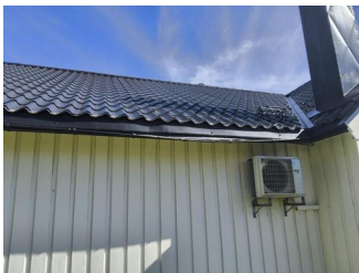
Takrenner og utvendige nedløp - Skade på takrenner
