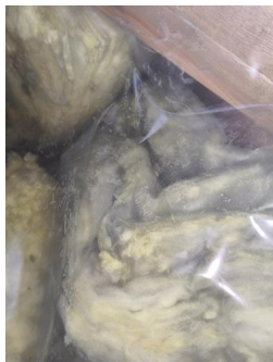
Annet - Åpninger i isolasjon i knevegg på kontor
