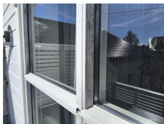
Vinduer og omramming - Slitt overflatebehandling
