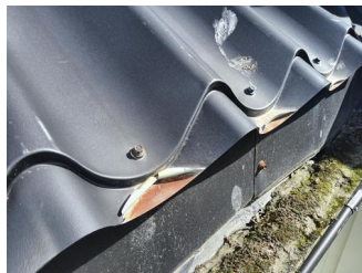
Tekking (med tilhørende beslag) - Løs overflatebehandling og overflaterust
