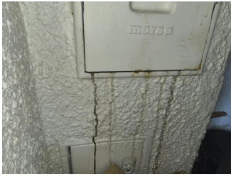
Skorsteiner inne i boligen - Fuktskjolder i sotluke
