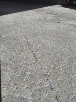
Fundament, grunnmur og gulv mot grunn - Riss i gulv på grunn
