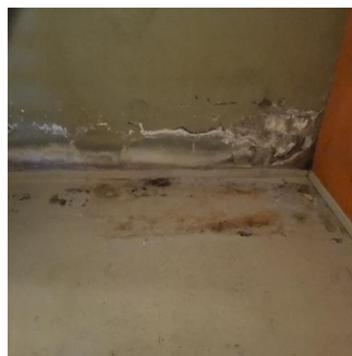
Helhetsvurdering - Eksempel på fuktproblematikk og salt-/kalkutslag
