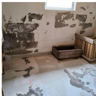
Helhetsvurdering - Eksempel på slitasjer og fuktproblematikk
