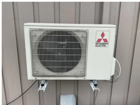
Luft/luft varmepumpe påvist fra 2013
