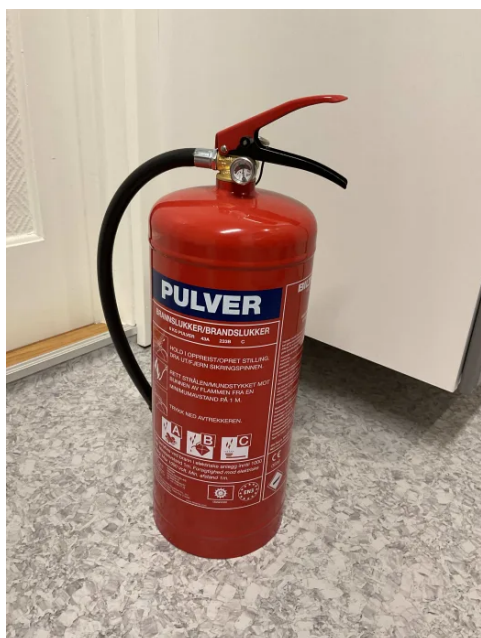
Brannslukningsapparat plassert inne på vaskerom
