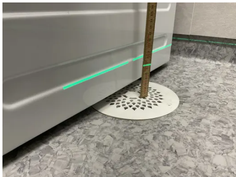
Gulv med noe mangelfullt fallforhold
