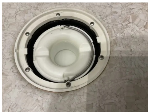
Belegg synlig ført under klemring
