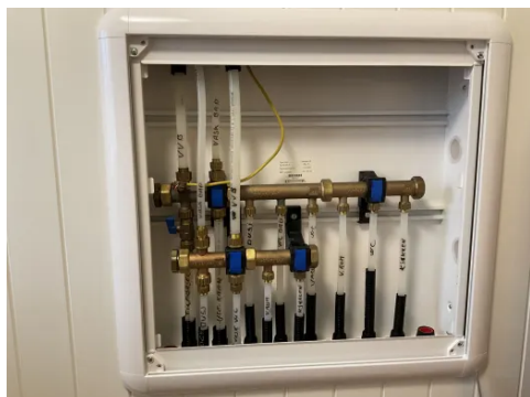
Fordelerskap plassert på innvendig bod/teknisk rom
