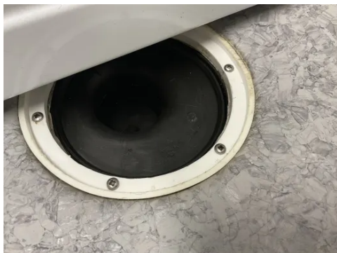
Belegg synlig ført under klemring
