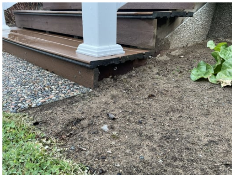
Ligger på terreng og utsatt for fuktopptrekk
