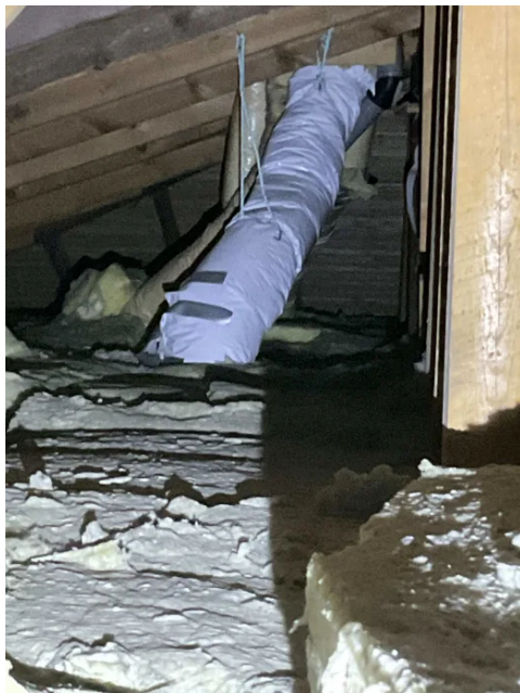
Synlig isolerte kanalføringer
