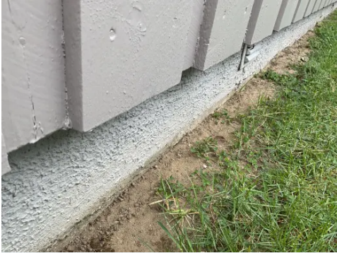
Ingen synlige utvendige fuktsikringer
