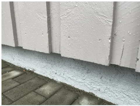
Kledningsbord med noe endeoppsprekking, begrenset omfang
