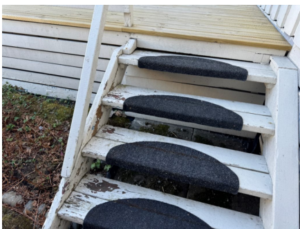
Trapp til terrasse uten rekkverk
