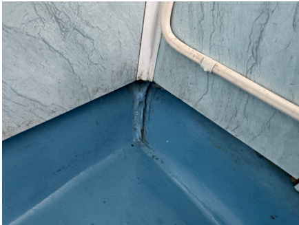
Ikke montert sokkellist på baderomsplater
