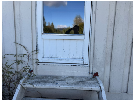
Slitasje i terrassedør
