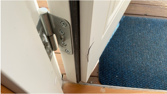
Skade på ytterdør
