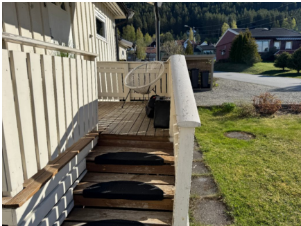
Trapp ved inngang med noe skjevheter
