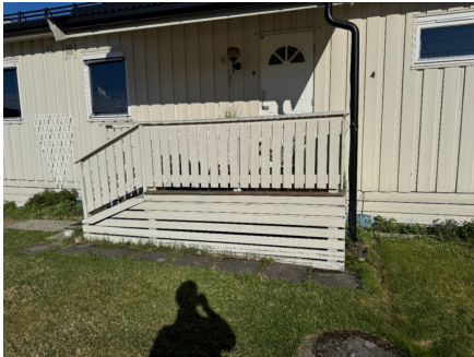
Veranda ved inngang med noe skjevheter og slitasje
