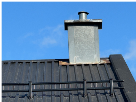
Luftelyre med noe slitasje i overflater
