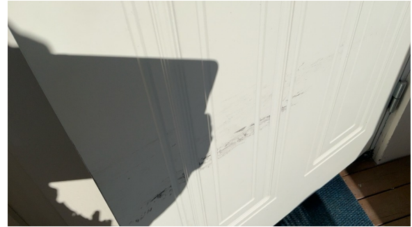
Skade i ytterdør
