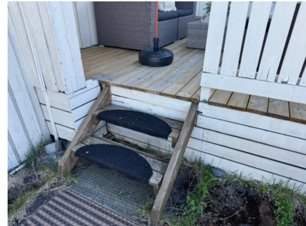
Trapp til terrasse uten rekkverk
