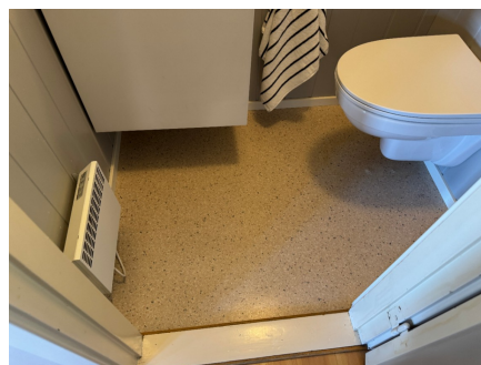
Ingen lekkasjedeteksjon under WC
