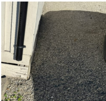
Taknedløp ført ut på terreng
