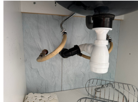
Utett rundt rørgjennomføringer i våtsone under vask
