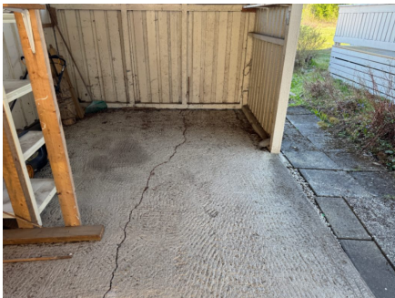
Sprekk i betongdekke
