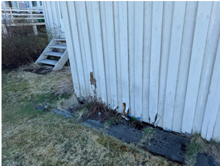
Råteskader i panel på bod
