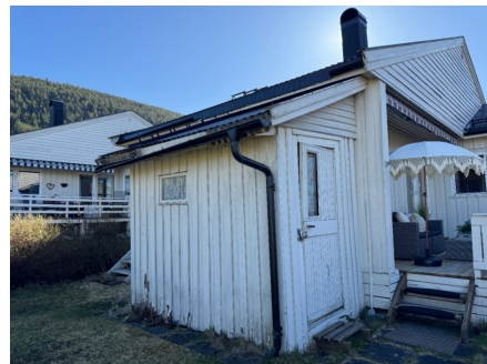
SKjevheter/skader i takrenner på bod med utvendig adkomst
