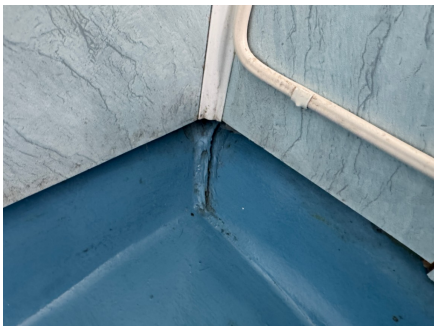
Utett belegg i oppbrett mot vegg
