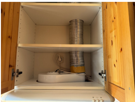
Rør fra ventilator ført ut
