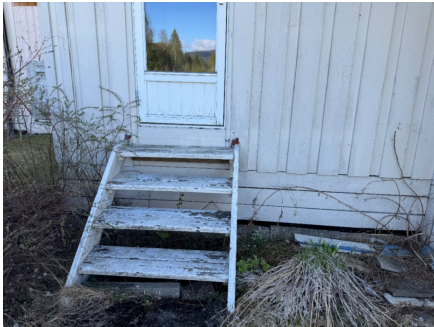
Trapp til terrassedør uten rekkverk
