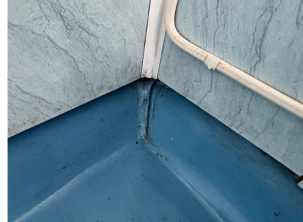
Utett belegg i oppbrett mot vegg
