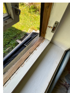
Slitte vindu og harde pakninger.
