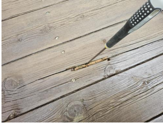
Tilstand på rekkverk og overflatematerialer - Råteskader terrassebord.
