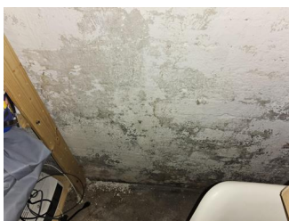
Overflate vegg - Saltutslag bod.
