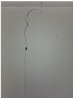
Grunnmur og fundament - Riss/sprekker grunnmur.
