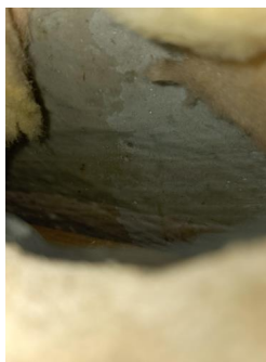
Kontroll i lukkede konstruksjoner - Fuktmerker utlektet kjellevegg.
