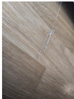
Overflate gulv - Ripe/hakk i stuegulv
