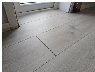
Overflate gulv - Fukt under gulvflater.
