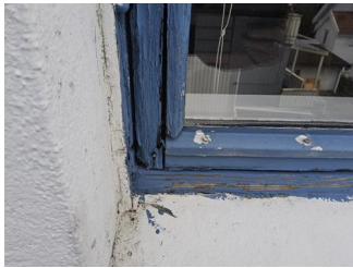
Vinduer og omramming - Råteskade.
