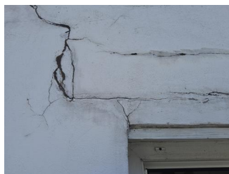
Fasader og konstruksjoner av mur, betong og lignende - Sprekker i yttervegg.
