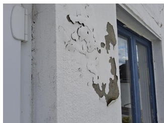
Fasader og konstruksjoner av mur, betong og lignende - Pussavskalling.
