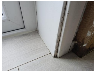
Ytterdører og omramming - Fuktskade på foringer balkongdør.
