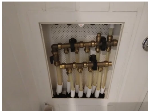
Vannskap for rør i rør system og hvoedstoppeventil.
