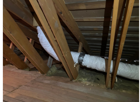
Isolert kanal-slange på loft
