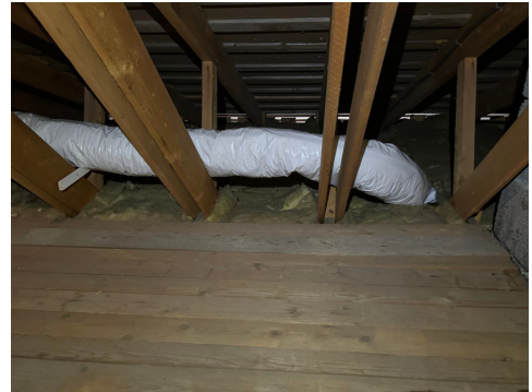
Isolert kanal-slange på loft
