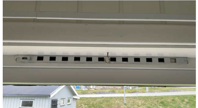
Spalteventil i vinduskarm.
