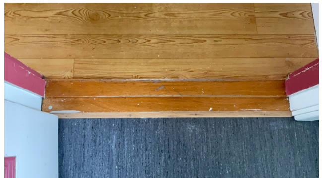
Det er ikke luftespalte i dørterskel.
